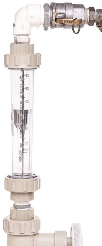
Imagem 1 – Rotômetro instalado e em operação
